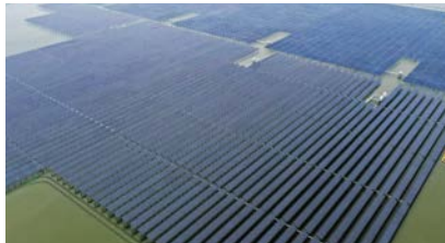
104MW Sihong, Jiangsu, Chine, 2018 Phase 1 Base Top-runner de complémentarité Pêche-Industrie photovoltaïque de Sihong
