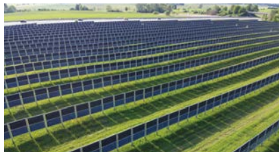
4.2MW Allemagne, 2020 Centrale photovoltaïque verticale bifaciale de type N
