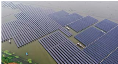
110MW Sihong, Jiangsu, Chine, 2020 Phase 2 Base Top-runner de complémentarité Pêche-Industrie photovoltaïque de Sihong
