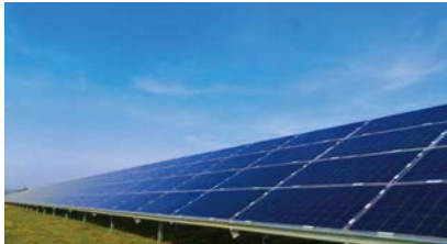
5.6MW Ukraine, 2019 Fruzynvka Centrale photovoltaïque bifaciale de type N
